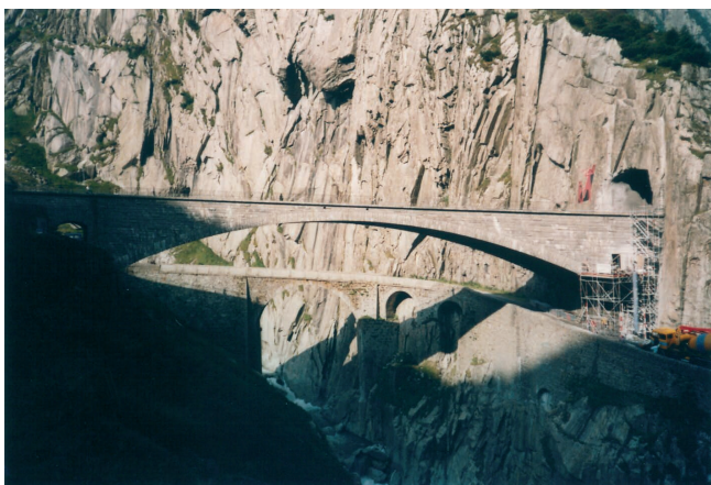
Sanierung Teufelsbrücke im Kanton Uri Assainissement du Pont du Diable dans le canton d'Uri.
